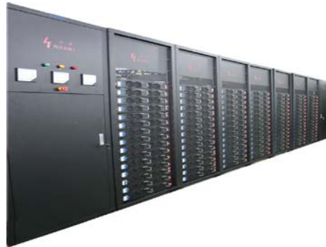
葫芦岛MW级充电系统
